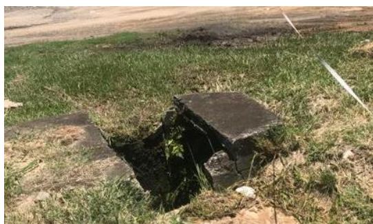
Figura 3: Drenagem para manutenção. Fonte: DEPAC - Keilla Miranda, 07/01/2020.
